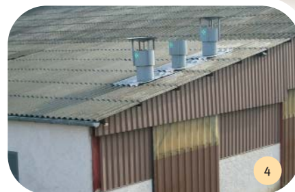
Les extracteurs de la salle de tétée.
